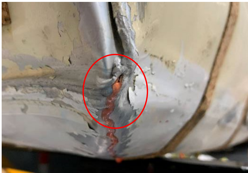
Figure 90 : fuite dans un coin du réservoir
