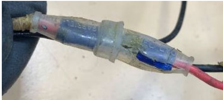
Figure 118 : cosses endommagées Source : BEA
