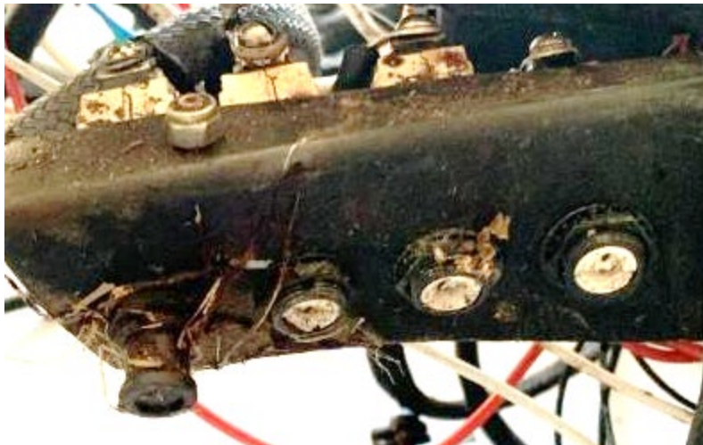
Figure 114 : breakers Source : BEA
