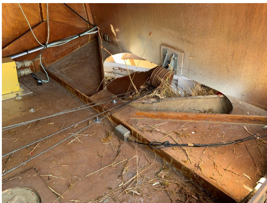
Figure 20 : câbles de commande à la liaison entre la poutre de queue et la cabine Source : BEA
